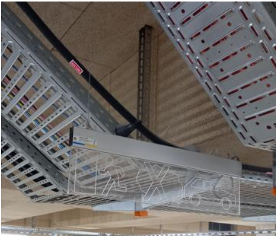
Abbildung 27: Strahlerkabel führt unmittelbar an der Notbeleuchtung vorbei => Hohes Potential für zusätzliche Rauscheinträge
