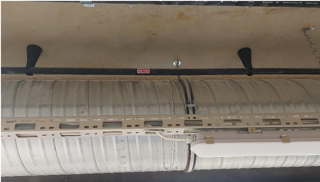
Abbildung 6: Beispiel Strahlerkabel, das von einer nachträglich verbauten Lüftungsanlage abgeschattet wird
